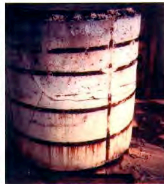
Coque bétonnée fissurée
